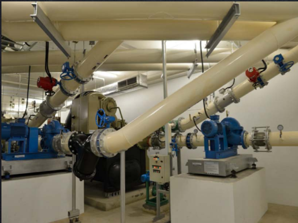
大きいパイプ, 小さいポンプ
